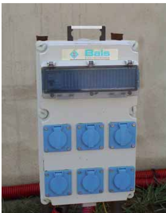
Un coffret électrique de chantier équipé d'un différentiel 30mA est installé dans un rayon de 25 m autour de chaque pavillon
