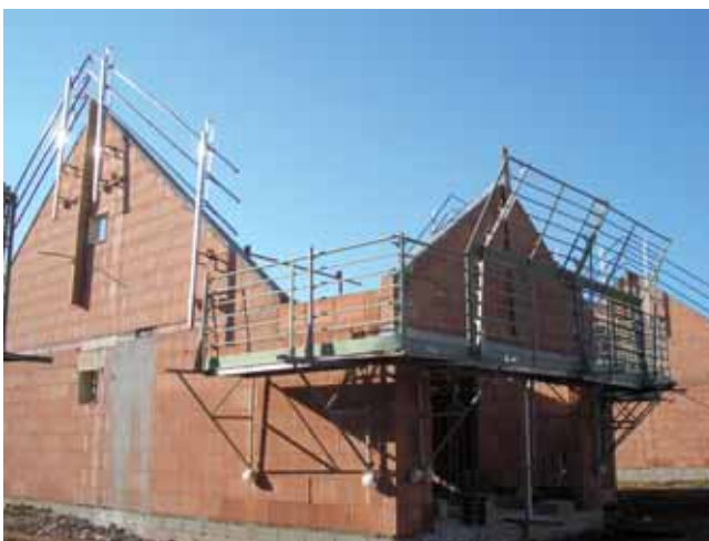
Les échafaudages périphériques sur consoles sont mis en commun entre les lots "gros-œuvre" "charpente" "couverture"
