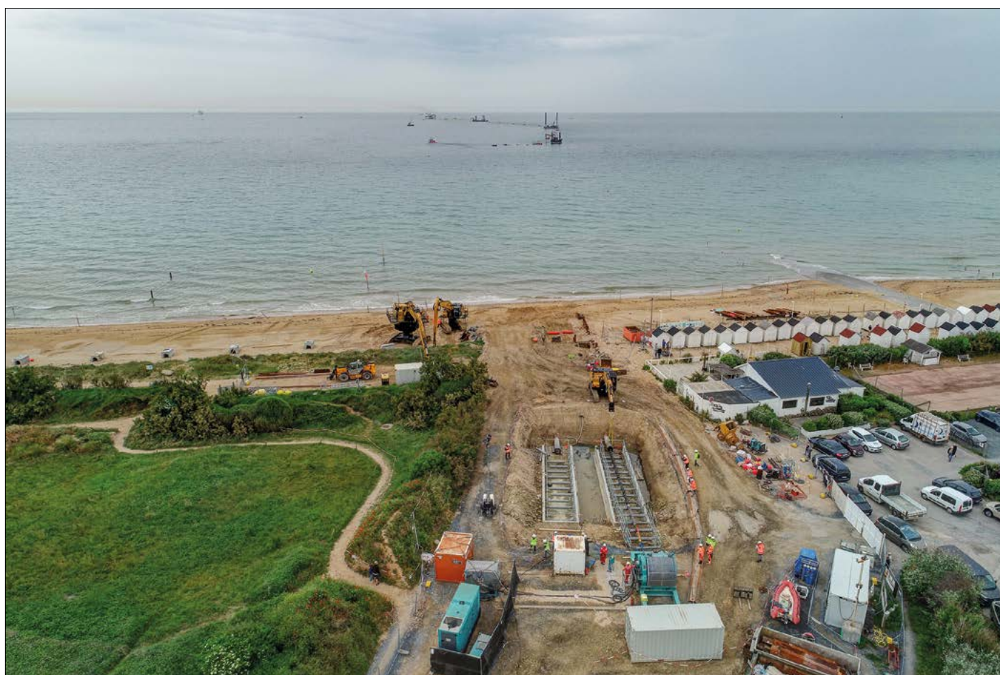
➡ La chambre d'atterrage où les câbles sous-marins et sous-terrain seront raccordés
